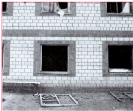
Последствия взрыва склада боеприпасов
