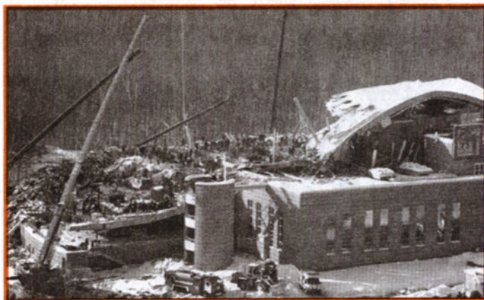
Ликвидация последствий обрушения кровли аквапарка «Трансвааль». Москва, февраль 2004 г.
