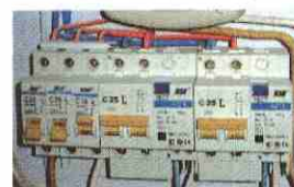
Рис. 91. Современный квартирный щиток с предохранителями
